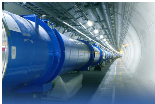
Jonowód LHC w tunelu.
